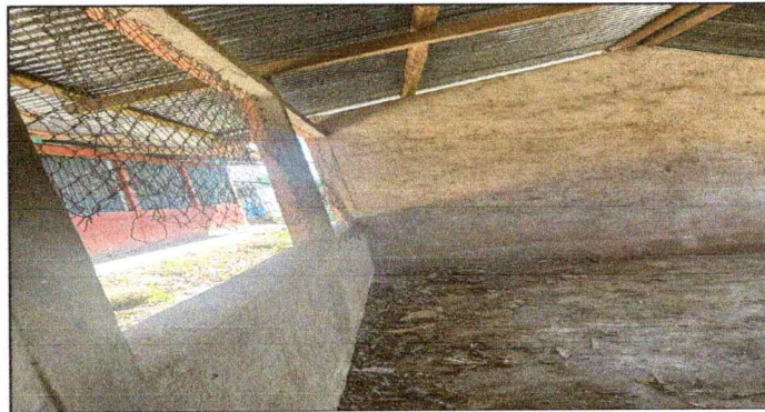
Foto 6: Se observa aula en mal estado y sin balcones.
