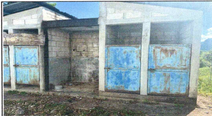
Foto 4: Se observa puertas de los baños en mal estado.
